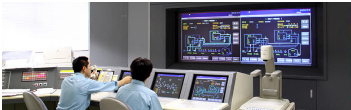
計器室での運転及び監視業務
