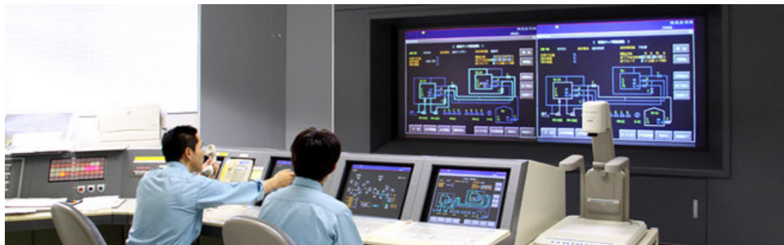
計器室での運転及び監視業務
