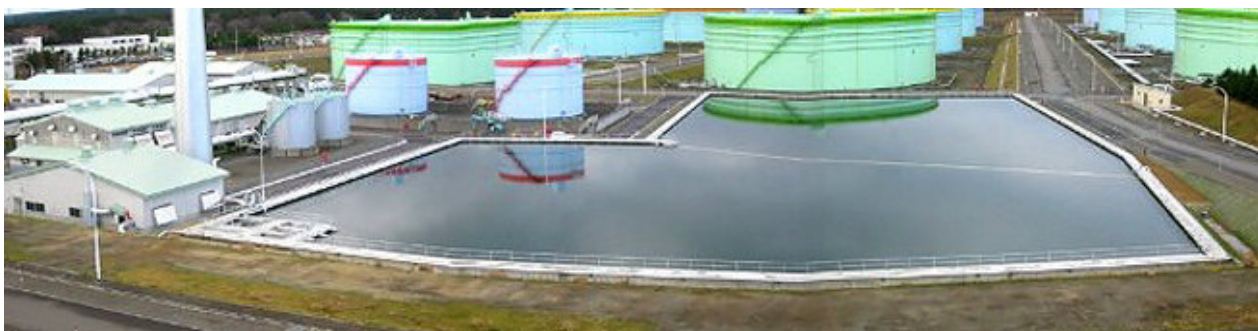
貯蔵基地貯水槽
